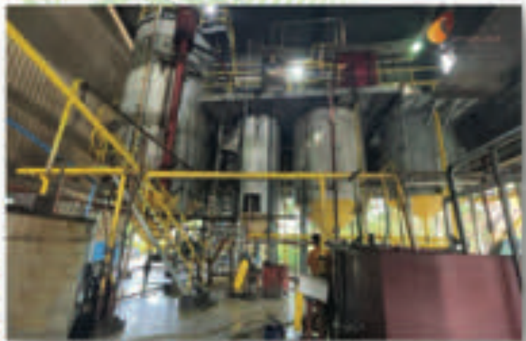
Station Clarification Mill PT. IKSJ, salah satu stasiun yang berperan penting dalam pabrik pengolahan kelapa sawit, terutama pada pengolahan crude palm oil (CPO)
